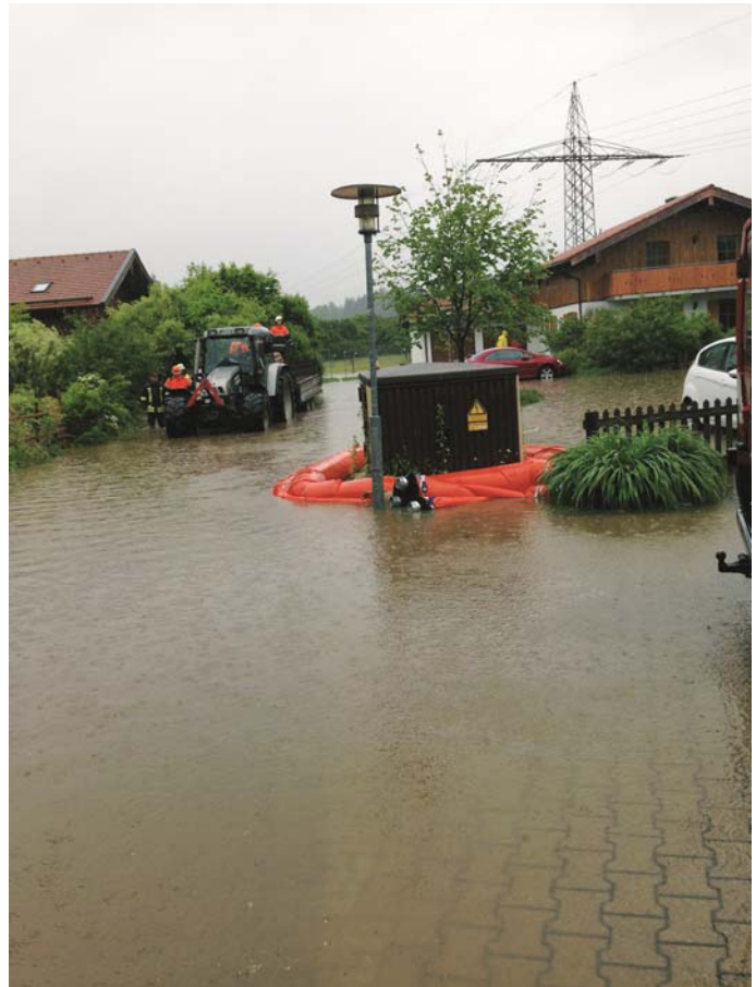
Vor einlaufendem Wasser geschützter Stromtrafo in der Weißdornstraße.
