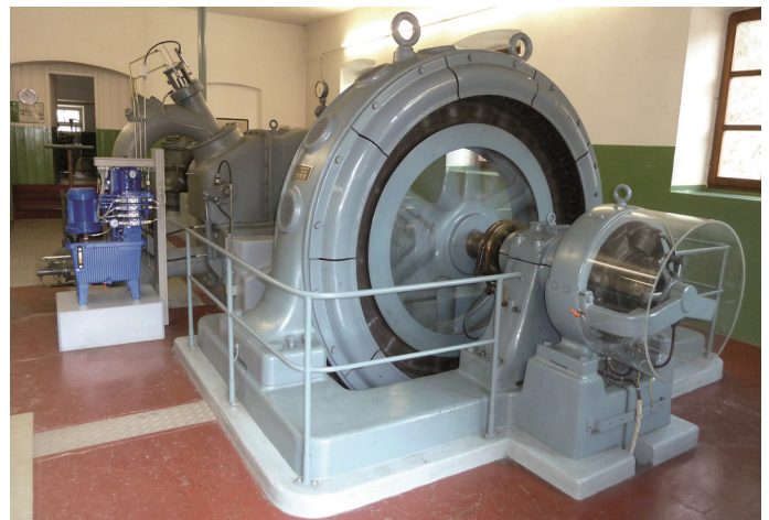
Die Turbinen im E-Werk Gernmühle stehen seit 1922 unverändert an ihrem Platz und erzeugen klimaneutrale Energie.
