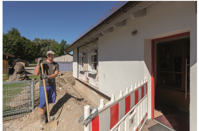
Das Feuerwehrhaus in Thansau ist wieder trocken
